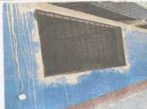
Foto 6: LAS VENTANAS FUE CAMBIADO POR METAL.
