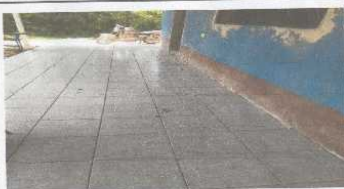
Foto 4: ASÍ QUEDO EL PISO CERAMICA POR PISO NORMAL.
